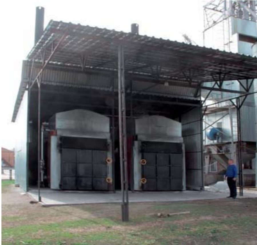
Рис.1 Загальний вигляд твердопаливного теплогенератора польської компанії MetalERG
